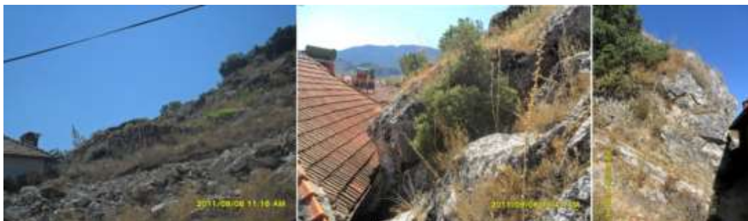
Resim 2.3 Burdur İli Ağlasun İlçesi Mamak Köyü Kaya Düşmesi Etüdü.
